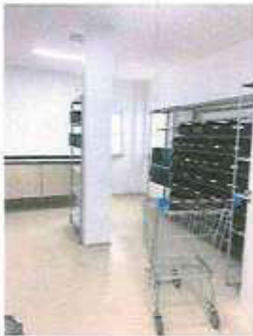
Raio x: sala sem equipamento (parede baritada SIC)
